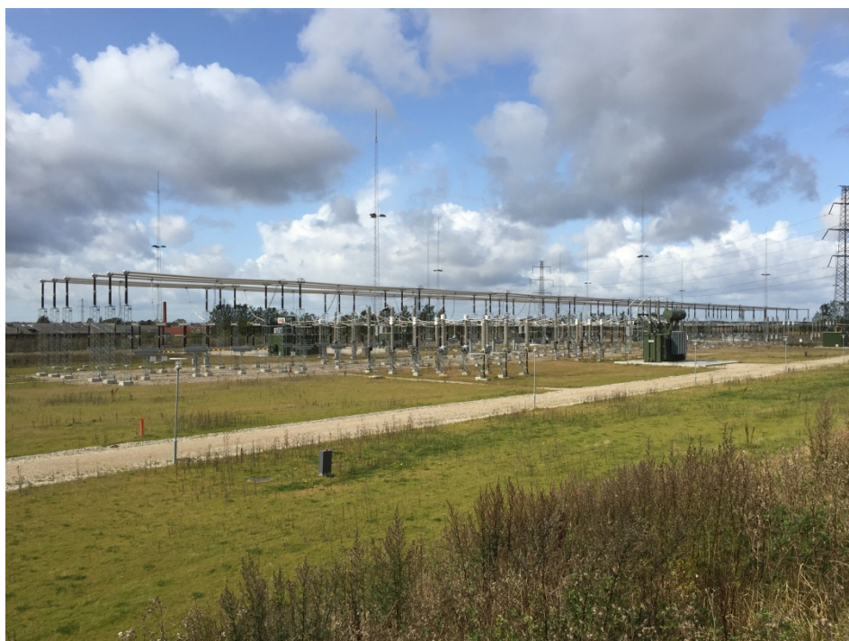
Figur 12 Eksempel på en 220 kV-AIS-station (Bjæverskov) – denne station indeholder fire kompenseringsspoler, to linjefelter og et transformerfelt (selve transformeren står ved 400 kV-stationen).
