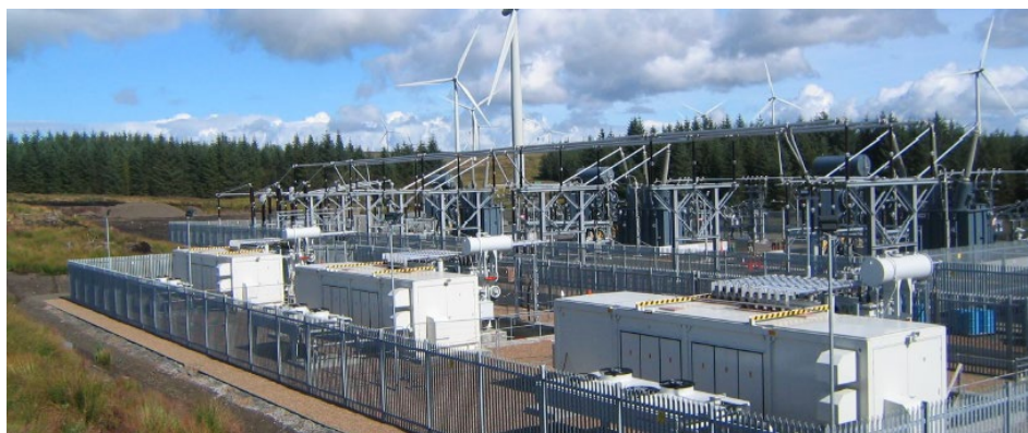
Figur 19 Eksempel på STATCOM, på billedet er vist 3 stk. Udseende og dimensioner varierer fra leverandør til leverandør. Kilde: ABB
