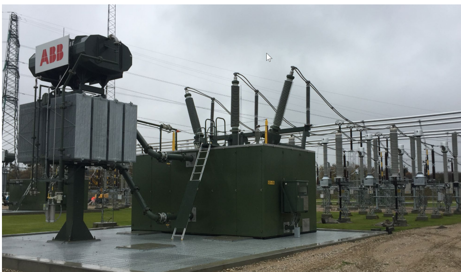
Figur 17 Viser en 220 kV-kompenseringspole (station Bjæverskov).
