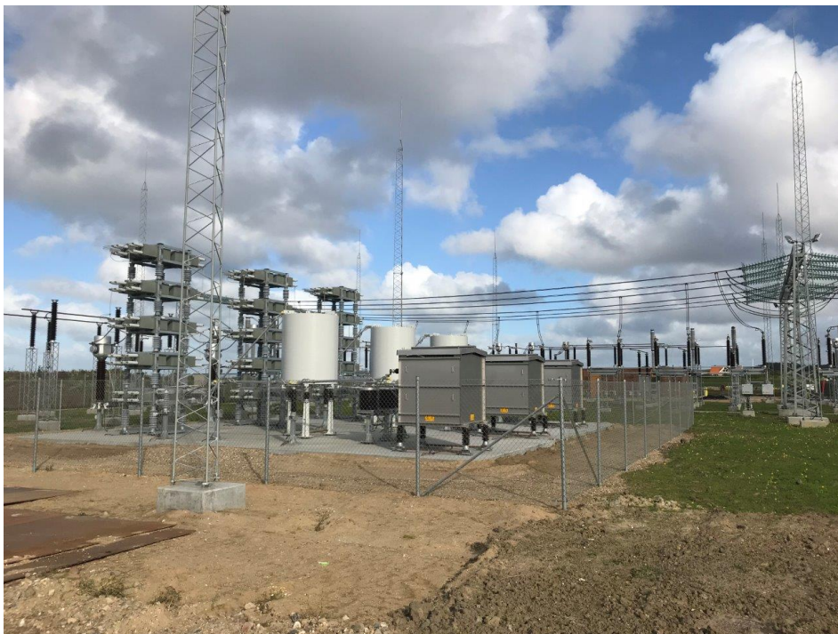
Figur 20 Eksempel på et 150 kV-filter. I baggrunden ses felter og samleskinner (station Engbjerg)
