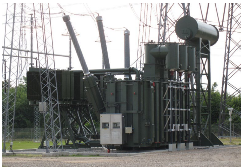
Figur 18 Eksempel på en 400/220 kV-transformer (station Bjæverskov).
