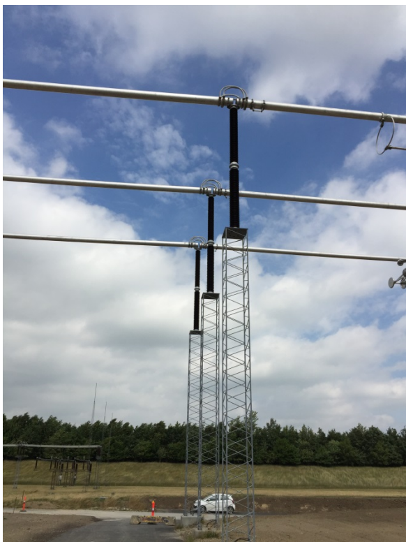
Figur 15 Eksempel på en del af en samleskinne i en AIS-station.
