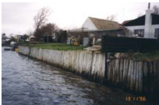
Skræntbeskyttelse af træpæle. Ingen strand foran
