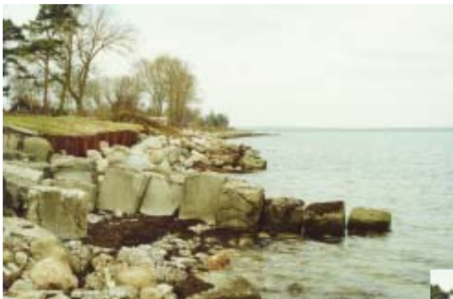
Ukoordineret, og uharmonisk skrænt- og høfdebeskyttelse hvor passage er vanskelig.
