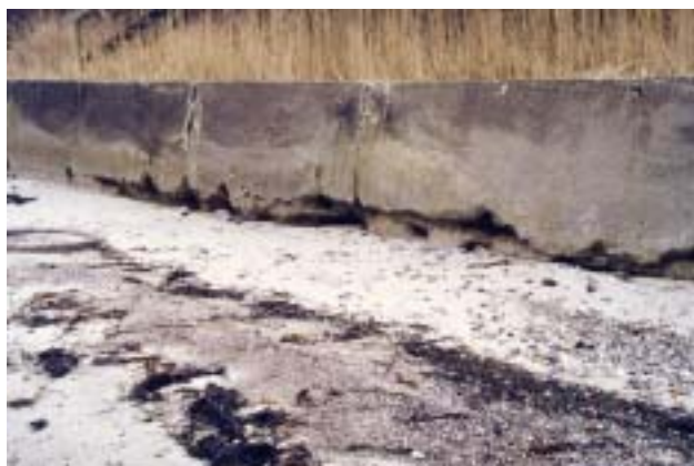
Betonmuren er slidt og i risiko for underminering.
