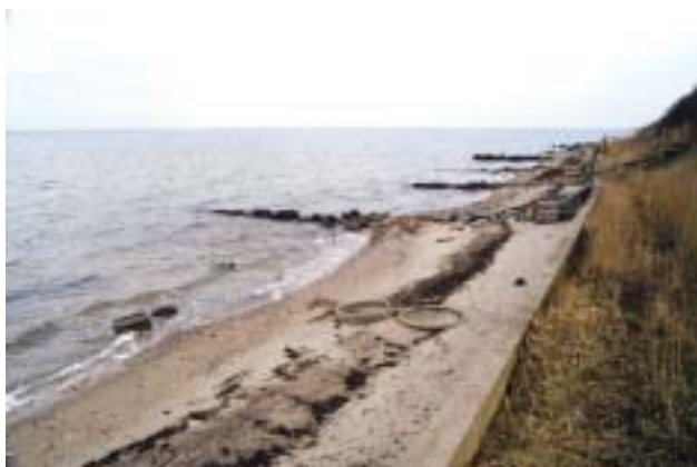
Smal strand og hofdebeskyttelse der ikke er særligt effektiv, foran slidt betonmur.
