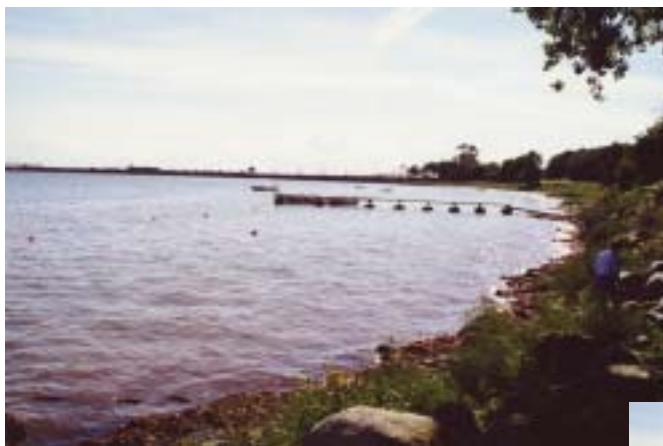
Ingen strand foran skræntbeskyttelsen på grund af læsideerosion fra havnemolen i baggrunden.
