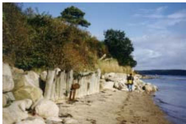
Skræntbeskyttelser af sten og træpæle. Stenene fylder den plads, som stranden udgør
