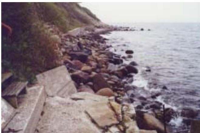
Forfalden skræntbeskyttelse med vanskelig passagemulighed.
