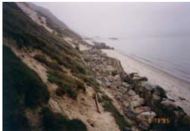
Forkert (Oprindelig pælerække er blevet utæt og undermineret. Der er efterfyldt bagved og foran med sten uden dog at opnå en effektiv beskyttelse)
