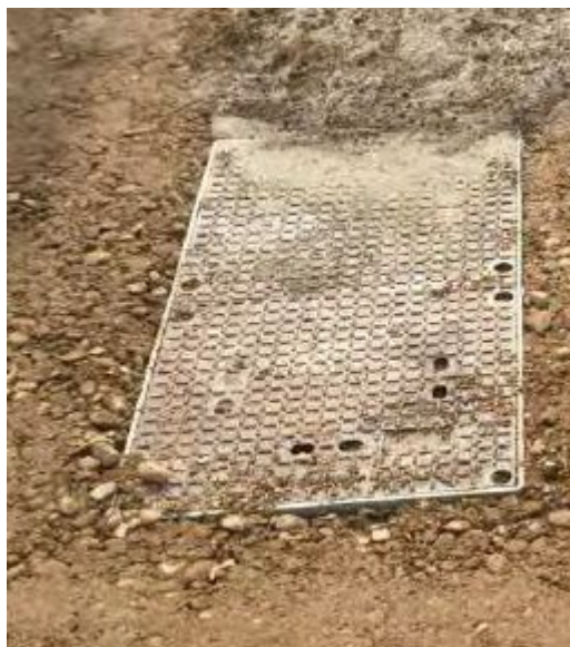
Figur 2-3 Eksempel på fiberbrønd i terræn
