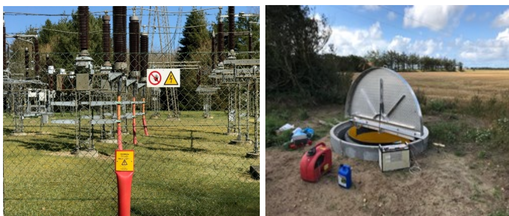
Figur 2-66 Eksempelfoto af markeringspæl og linkboksbrønd
