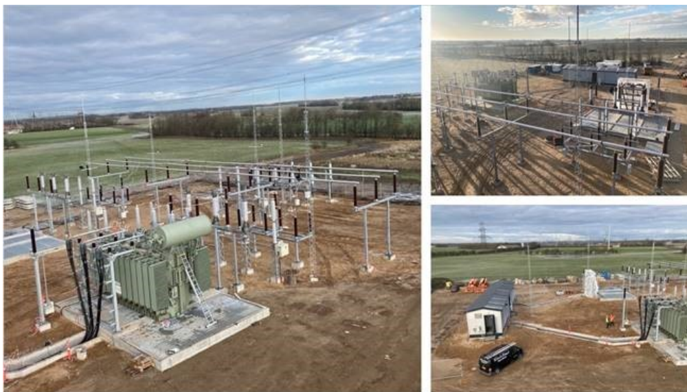
Figur 2.4 Eksempel på delvis åben transformerstation
