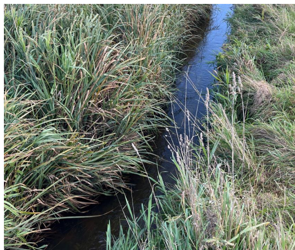
St. ca. 3.800, kraftige brinkfødter/indsnævret vandløbet
