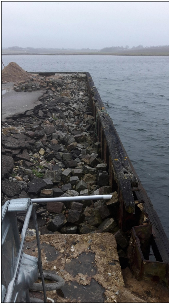
Spunsvæg stærkt tæret, belægning ødelagt af storm
