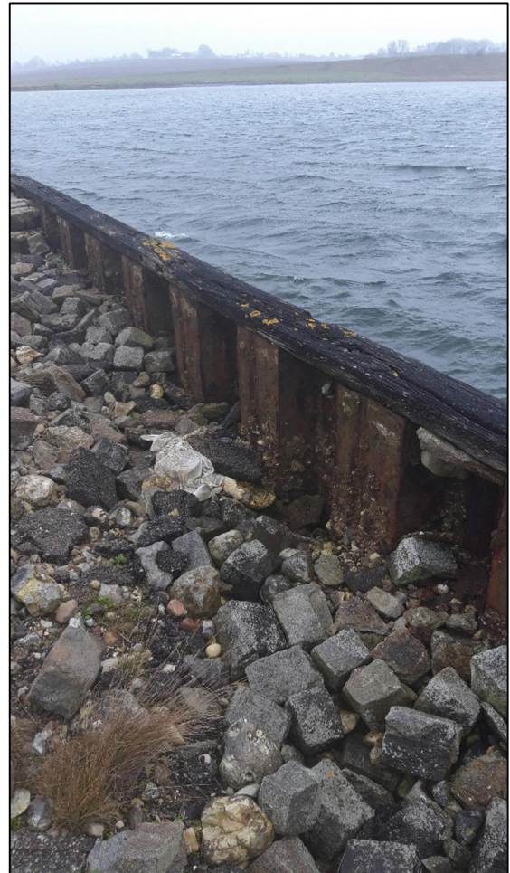
Spunsvæg stærkt tæret, belægning ødelagt af storm
