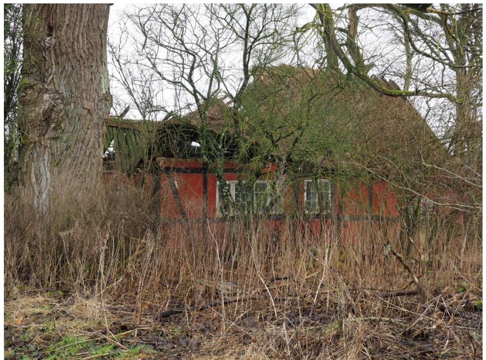
Figur 10-14 Den nordlige af de to faldefærdige bygninger.
